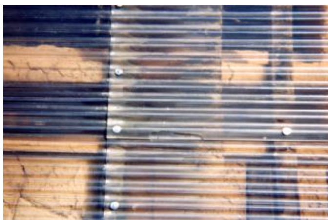
写真：クレオソート油によって腐食したポリカーボネート波板
