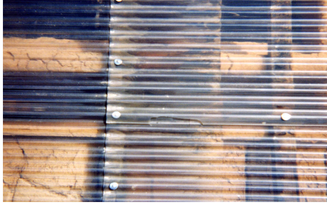
写真：クレオソート油によって腐食したポリカーボネート波板（通常品）
